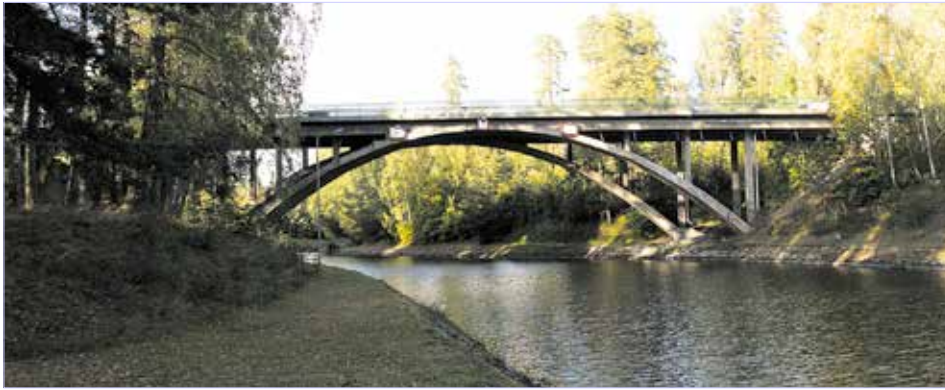
Nykyisen vuonna 1959 valmistuneen sillan kunto on todettu heikoksi eikä sen vahvistamista tai peruskorjausta pidetä taloudellisena.
